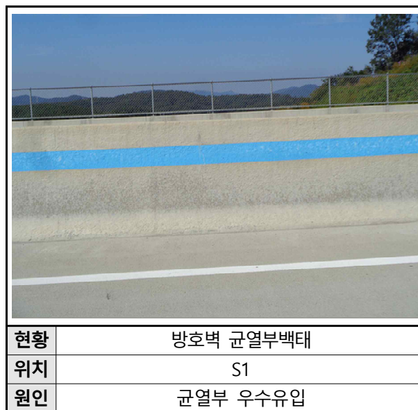
[표 3.2.3] 방호벽 및 방음벽 손상현황
